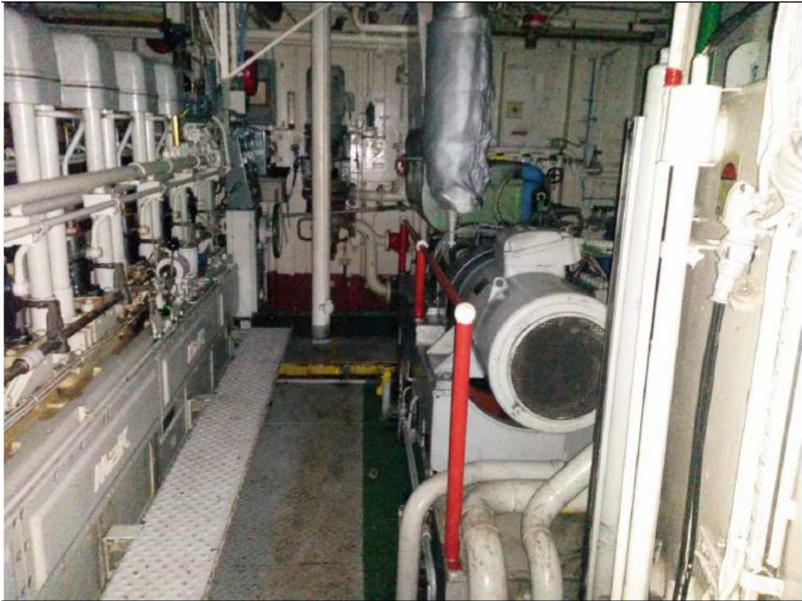
Foto 3 – Motore propulsione e generatore diesel
