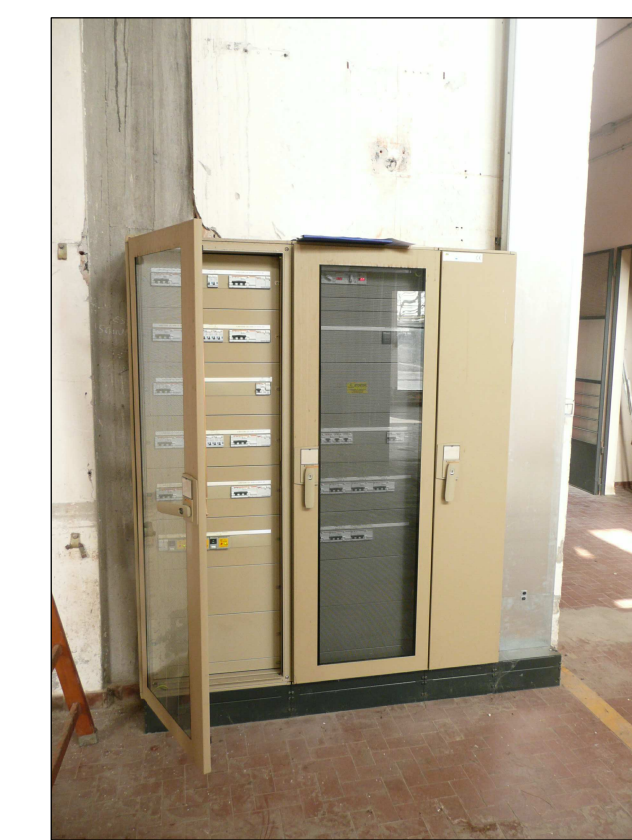
QUADRO ELETTRICO GENERALE CAPANNONI "C-D-E" OGGETTO DI INTERVENTO. PREVEDERE IL NUOVO CABLAGGIO, NUOVE PROTEZIONI E RICERTIFICARE.
