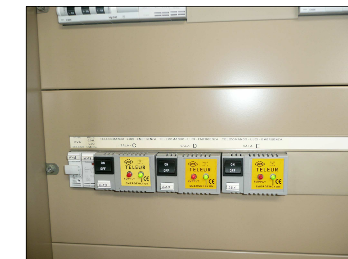
CENTRALINE IMPIANTO DI CONTROLLO ILLUMINAZIONE DI SICUREZZA ESISTENTI E RECUPERATE
